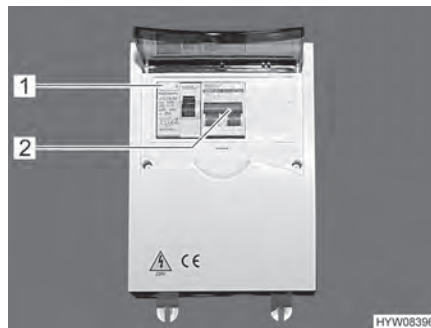
Afb. 116 230-V-zekeringenkast met beveiligingsautomaat en FI-schakelaar
